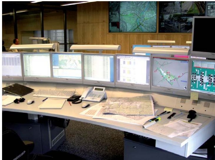
Pomieszczenie kontroli Zintegrowanego Centrum Zarządzania Ruchem
